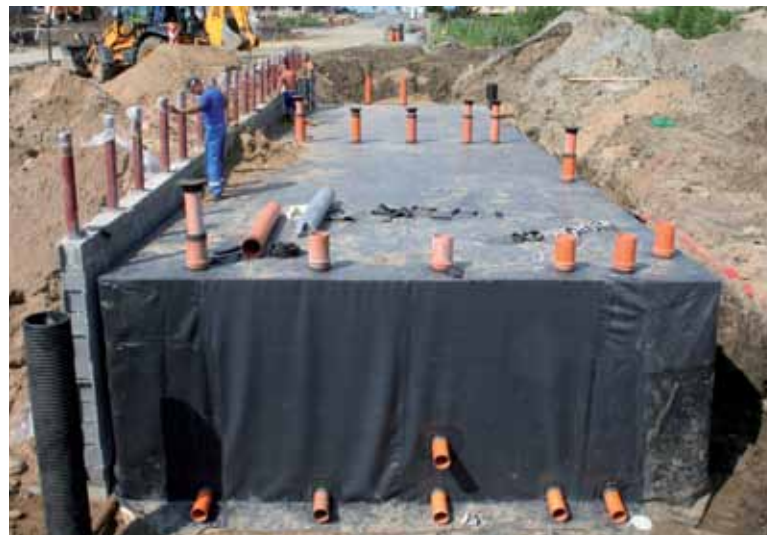
Буферный резервуар в дренажной системе
